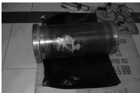
图2 故障电缆中间接头铜套外观图
