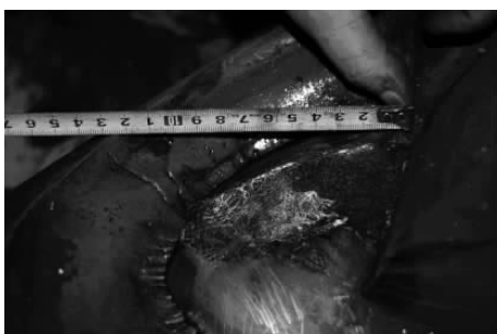
图4 故障电缆中间接头击穿点图
