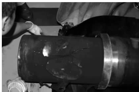
图3 故障电缆中间接头环氧件外外观图
